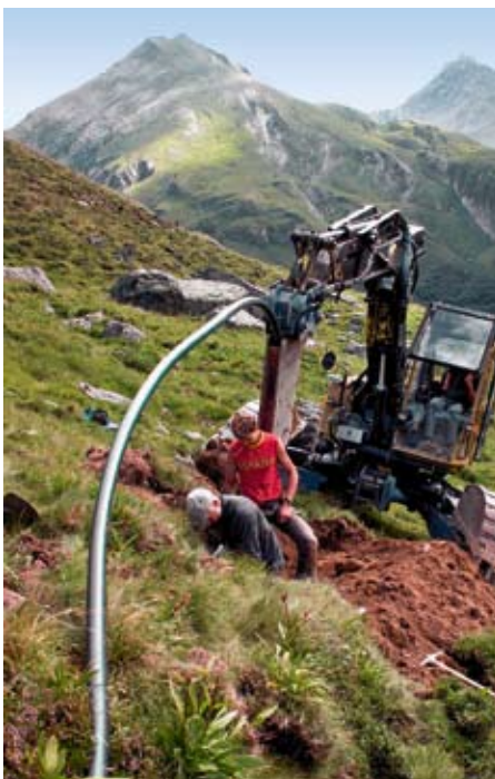
Im Sommer 2006 erstellte die Alpkorporation Foo ein Klein-Wasserkraftwerk, das auch die Wasserversorgung einschliesst. Für die Verlegung der Wasserleitung und der Elektrokabel kam ein Schreitbagger der neuesten Bauart zum Einsatz. (Bild Werner Blumer)
