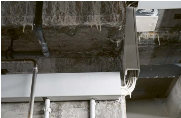
Stalaktiten: Sie zeigen, dass der Boden im Hallenbad und in den Nasszellen undicht ist. Es gibt im Untergrund diverse Orte, wo das Wasser so oder ähnlich von der Decke herunterläuft.
