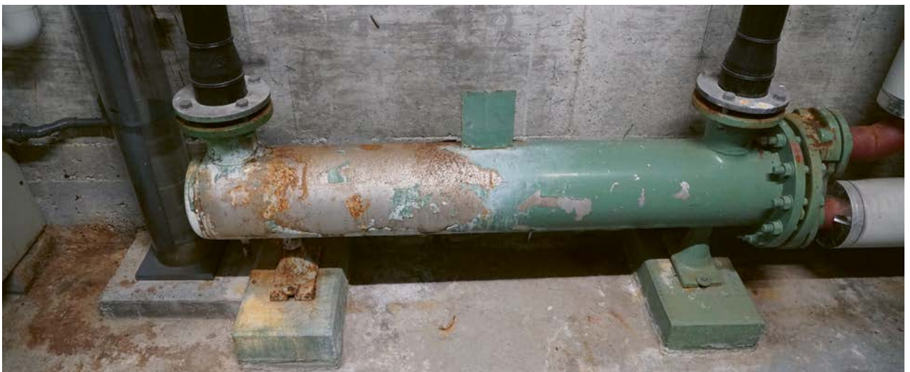
Der Badewasser-Wärmetauscher: Er unterstützt das Vorwärmen des Frischwassers für das Bad. Dieser Wärmetauscher ist seit Beginn (1977) im Hallenbad im Einsatz.
