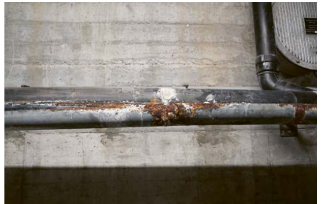
Überlauf PVC-Leitung, die das Badewasser ableitet: Es gibt diverse solcher Stellen, die nicht mehr 100-prozentig dicht sind. Es wurde vor Jahren mit Blech eine Notlösung konstruiert, um das Wasser aufzufangen und abzuleiten.
